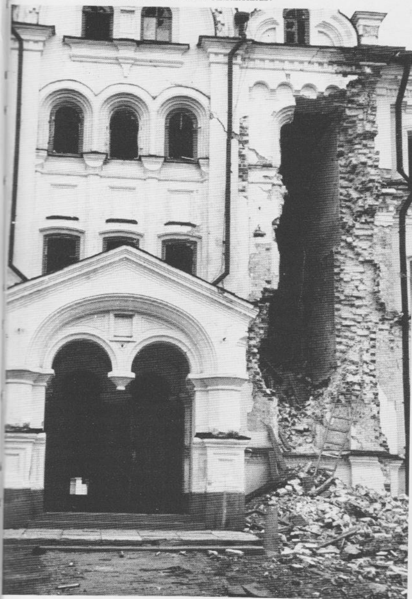
Sodassa vaurioitunut hotellirakennus.
